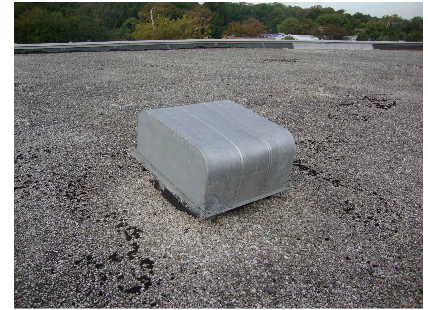
PHOTO # 28 - EXHAUST FAN
